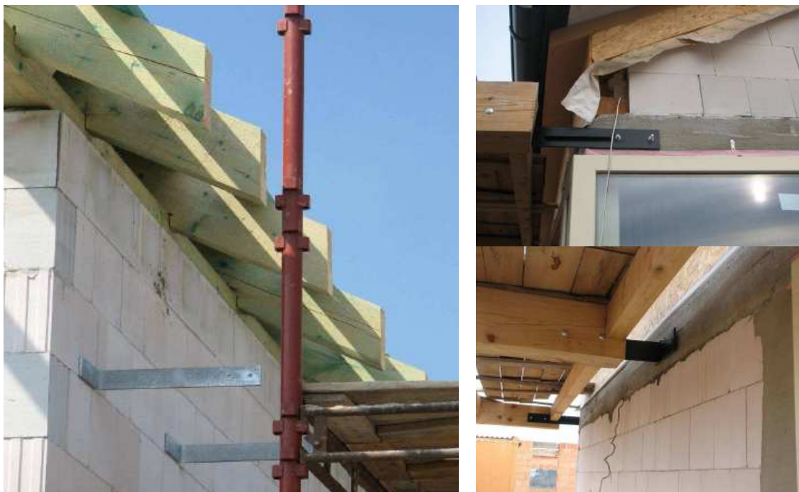
Obr.8:Příklady ocelových kotev, které skrz masivní tepelnou izolaci budou tvořit významné tepelné mosty. Řešení těchto detailů je špatně neprojektované.
